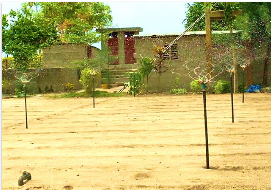
Figure 3 : Système d'irrigation par aspersion de VIMAS © MAGNON, 2017
